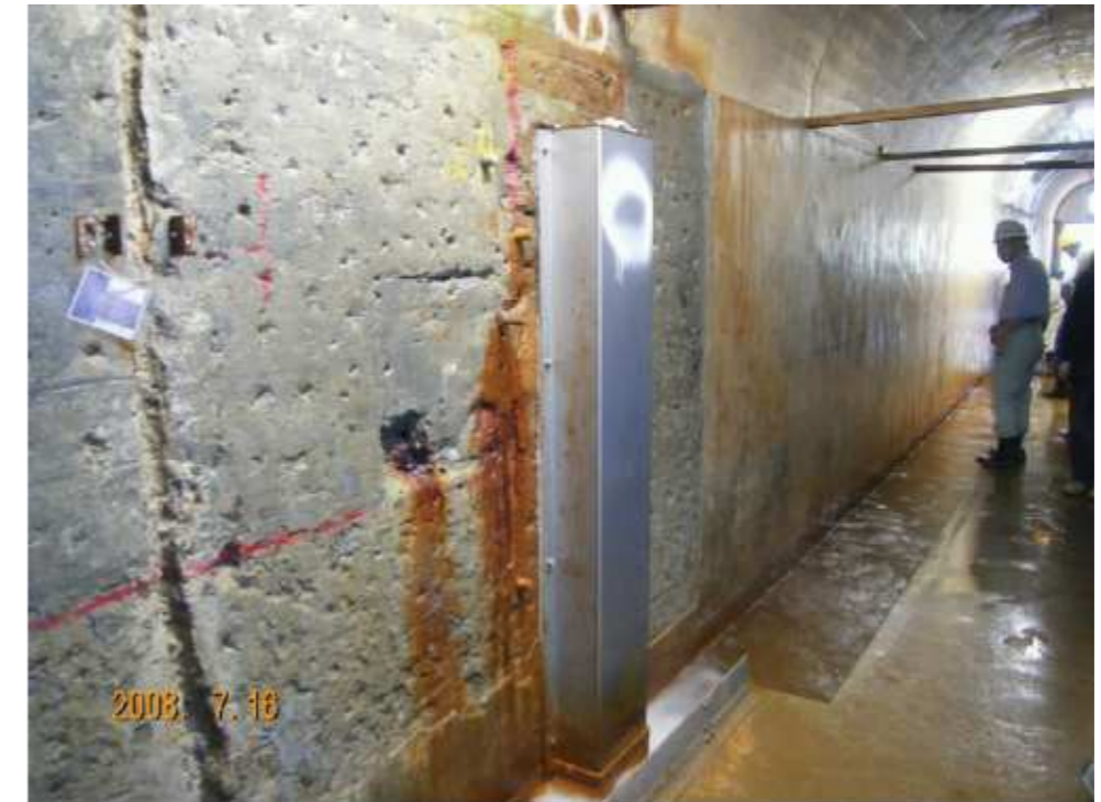
写真-1.1.2 飛散防止カバー設置後の状況 (調査のため周辺のもルタルをはつてある)
