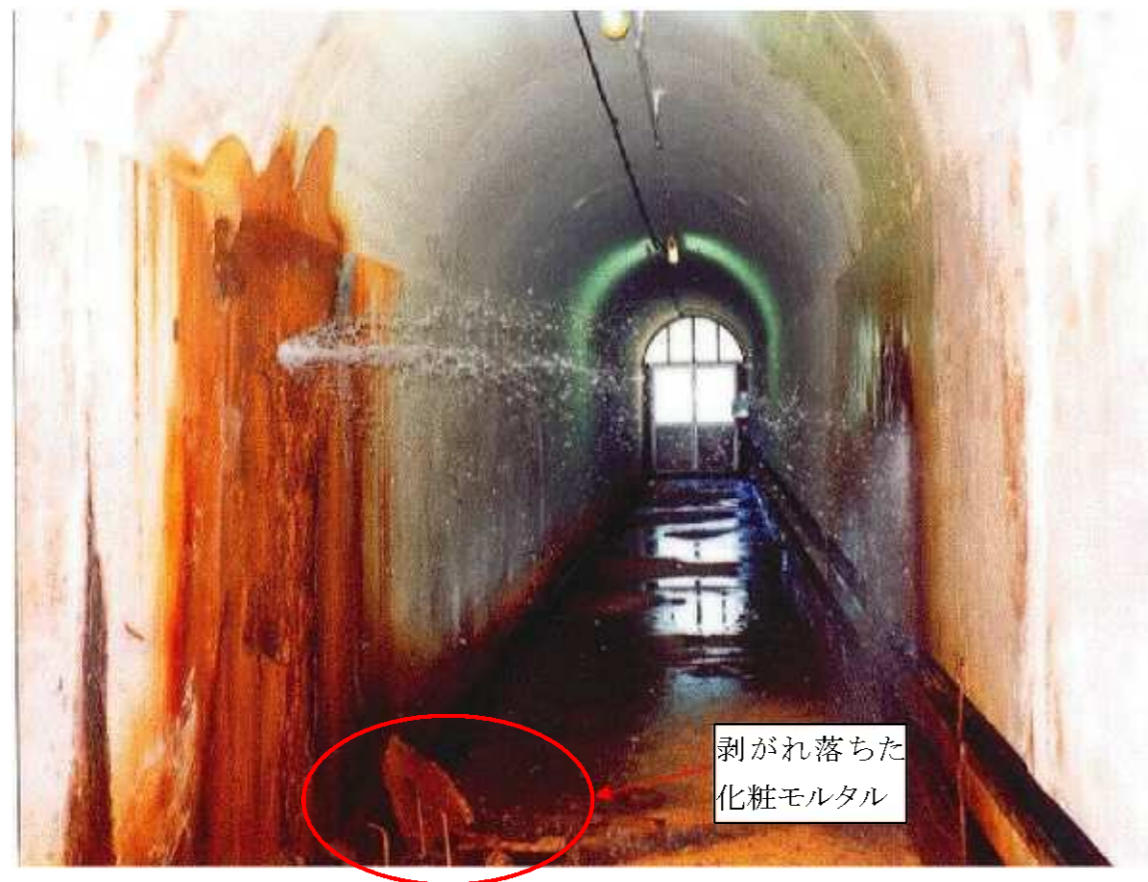
写真－ 1.1.17 漏水発生直後の状況 (H12)
