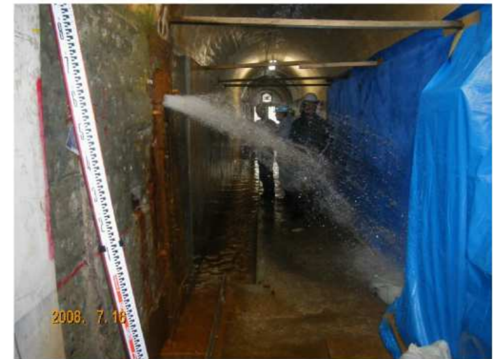
写真-1.1.3 4BL漏水箇所の飛散防止カバーを外した状況(平成20年7月)
