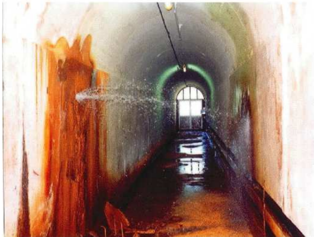
写真-1.1.1 飛散防止カバー設置前の4BL漏水箇所(平成12年頃)
