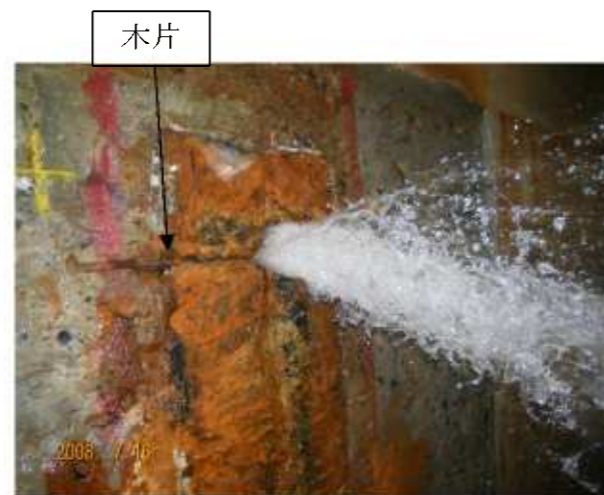
写真－ 2.2.1 4BL 漏水箇所の状況 (2008 年 7 月 16 日調査)
